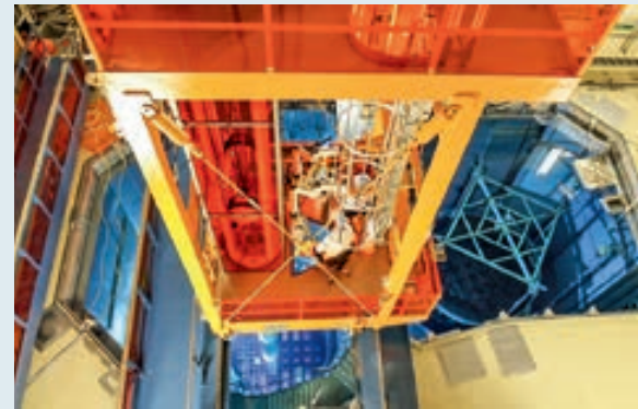
Lademaschine im Einsatz über Reaktorbecken
