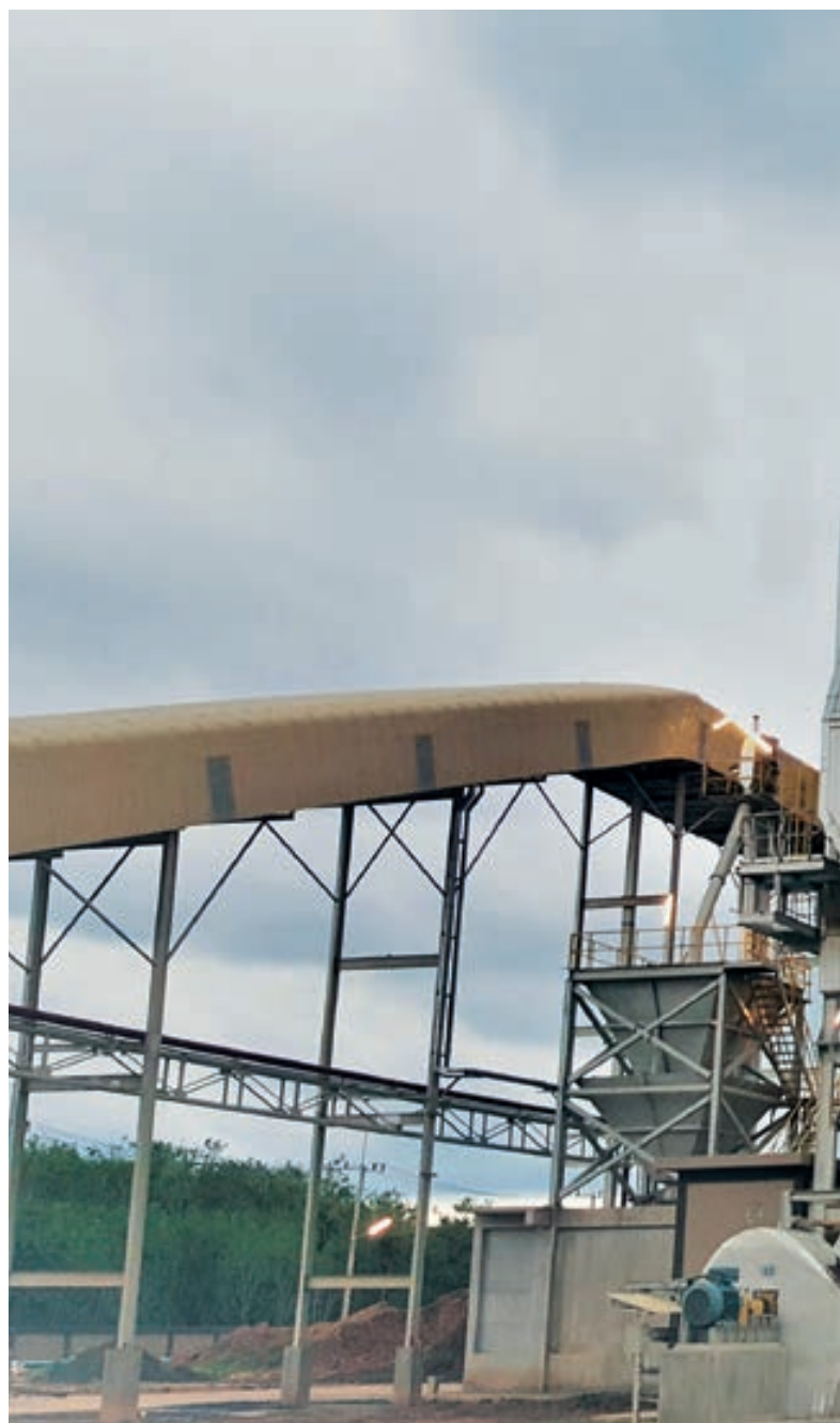
Panel-Plus-Anlage in Hai Yai (Quelle: BIB)
