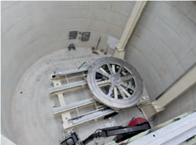
Blick in den Wassertank auf den Drehtisch der Volumenreduktionsstation (VRS)
