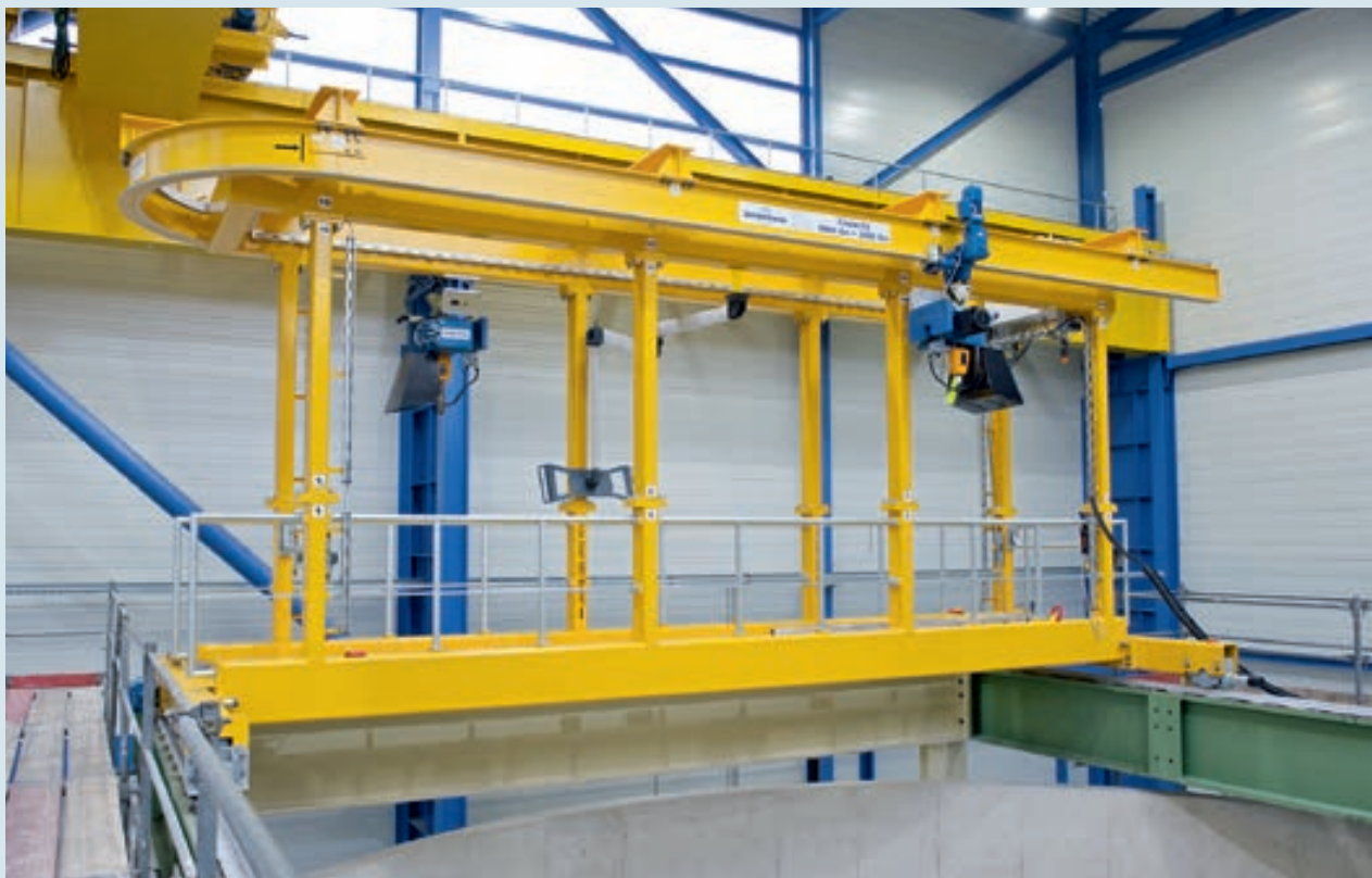
Arbeitsbühne mit Hilfszügen, Lieferumfang der SKT
