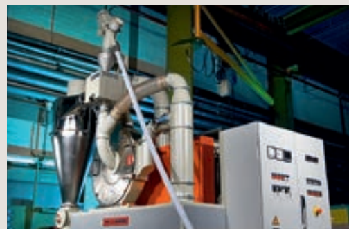
Anlage zum Feinmahlen von Masterbatch
